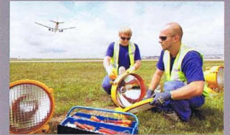
Das Airport Facility Management ist unter anderem für Betrieb und Instandhaltung der technischen Anlagen verantwortlich. Das umfasst auch gebäudetechnische und passagierrelevante Anlagen.
